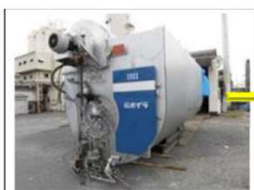
重油式ボイラー
