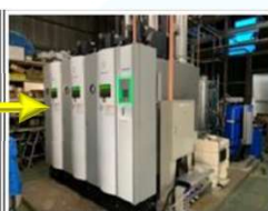
ガス式ボイラー
